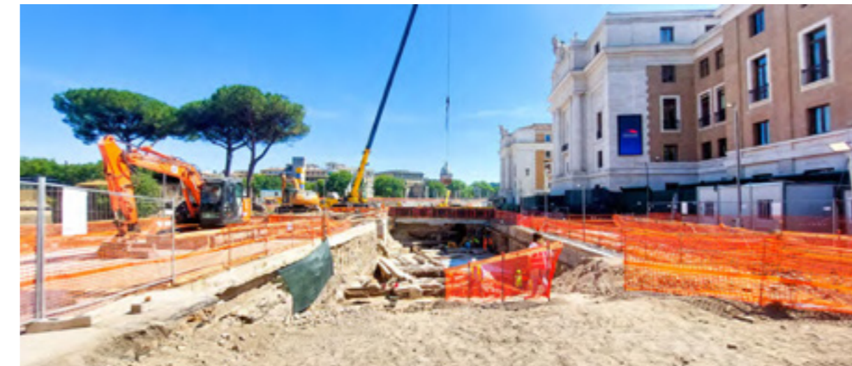
Inizio dello scavo del sottovia e primi rinvenimenti archeologici | ©arch. Felipe Lozano Lalinde
