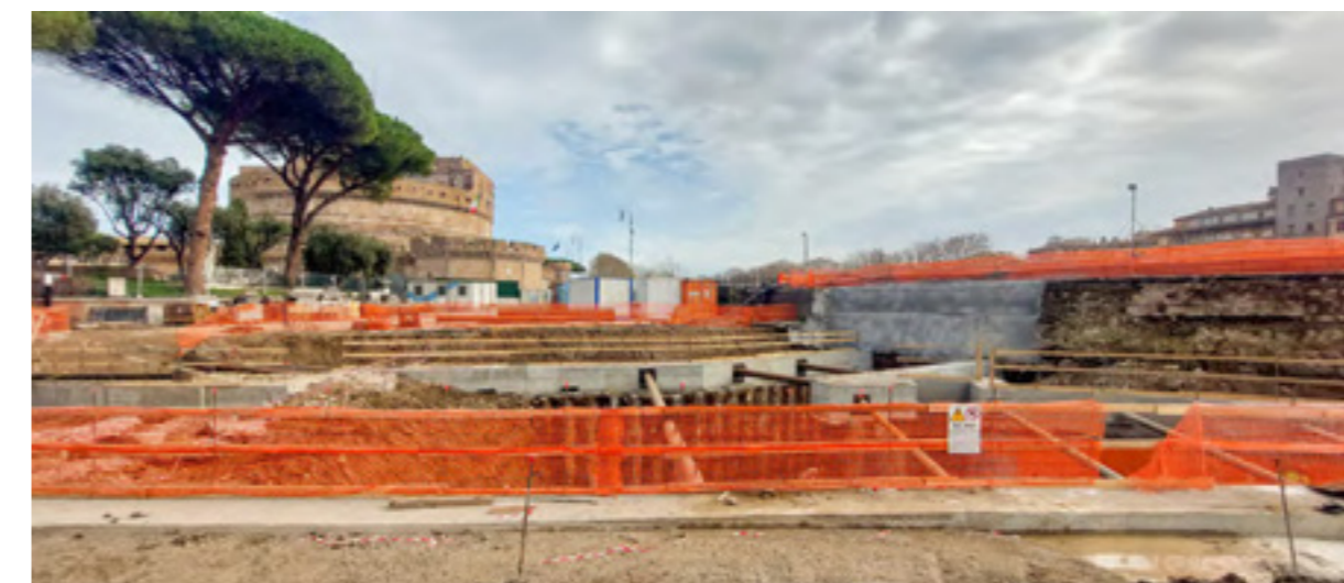
Opere di contenimento del terreno, puntellate in testa, propedeutiche alla realizzazione del sottovia | ©arch. Felipe Lozano Lalinde
